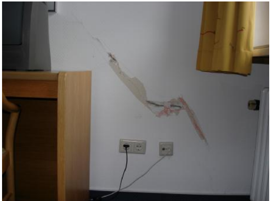
Riss im Bereich der Zimmertrennwand
