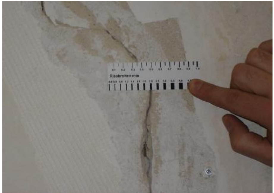
Rissbreit in Höhe von 1,60 m ca. 2,0 mm
