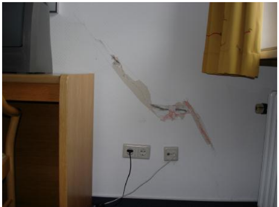
Riss im Bereich der Zimmertrennwand
