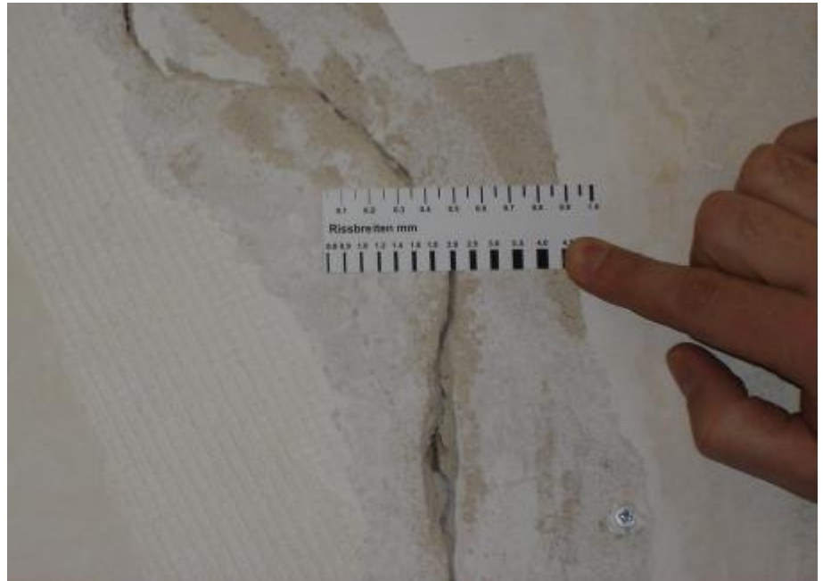
Rissbreit in Höhe von 1,60 m ca. 2,0 mm
