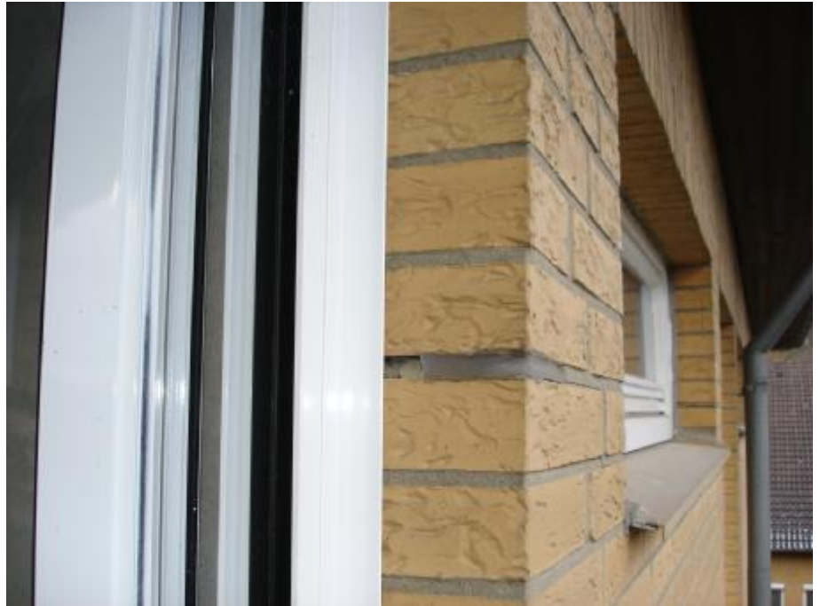
Gerissene Lagerfuge der Verblendung mit Silikon ausgebessert
