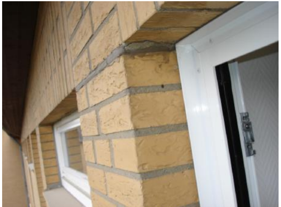
Gerissene Lagerfuge der Verblendung mit Silikon ausgebessert
