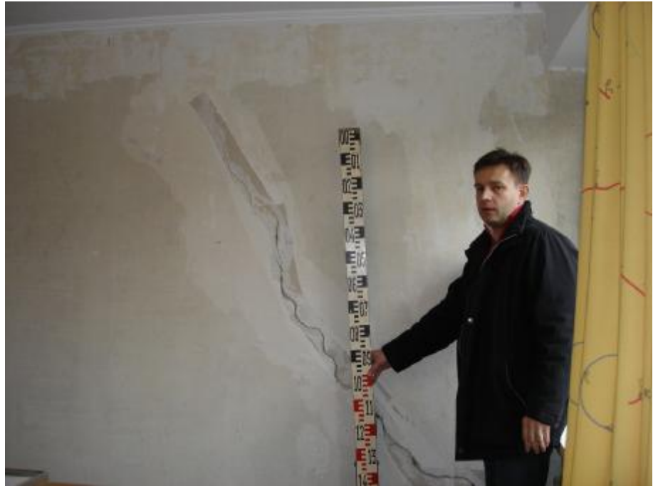
Treppenartiger Verlauf des Risses
